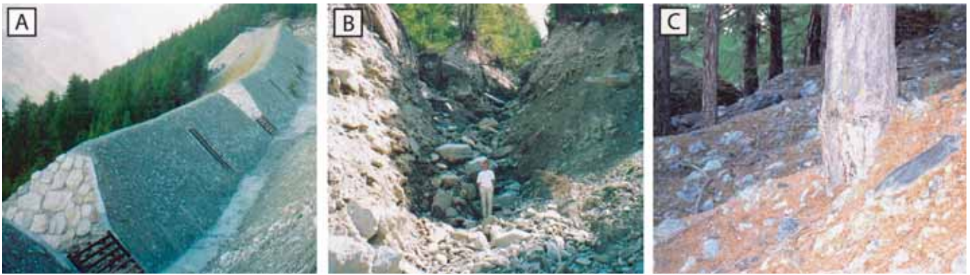
Bild 3. (A) Der unterste Damm mit den Durchlässen für die Murrinnen. (B) Die Rinnen Mitte und Süd fließen bei Kote 1650 zusammen und münden in ein Auffangbecken. (C) Murgangablagerungen unterhalb des untersten Damms weisen auf frühere Muraktivität der Rinne Nord in diesem Bereich hin.
